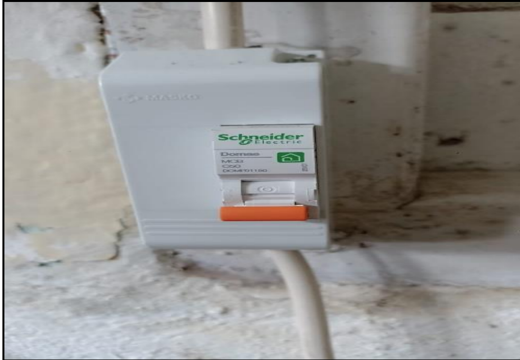
Gambar 2. MCB C50 Instalasi Listrik Laboratorium Komputer
